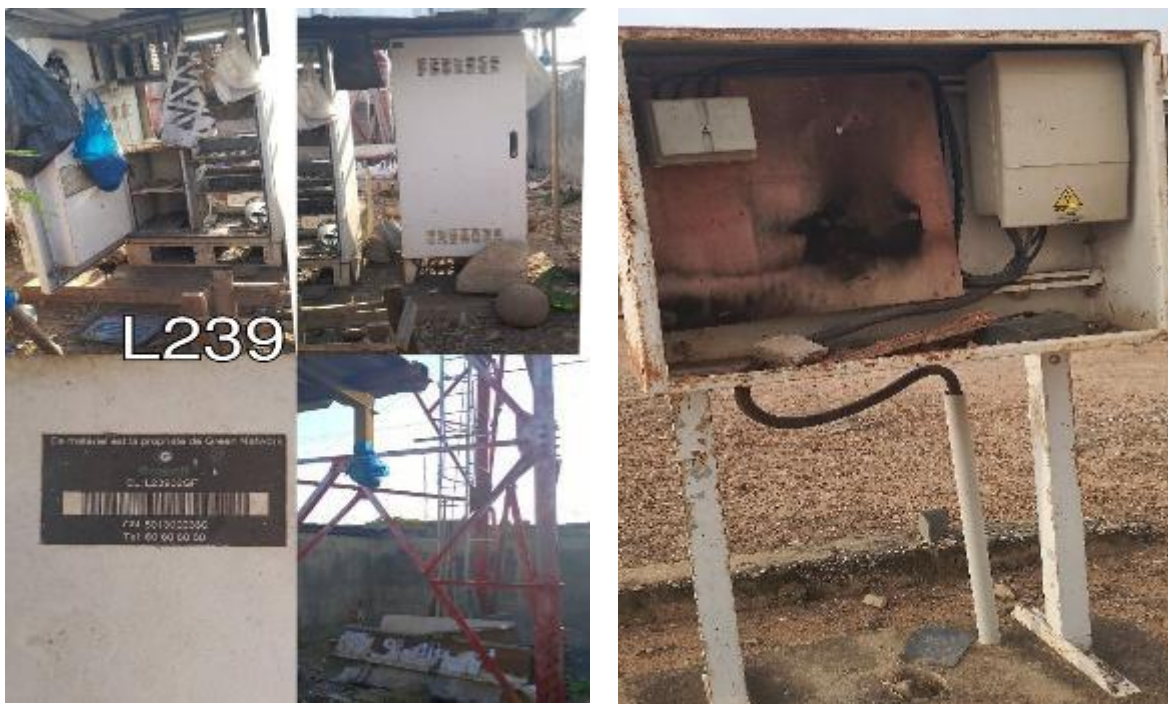
Pylône et armoire électrique abandonnés par l'ex-opérateur Green à Bouaké
