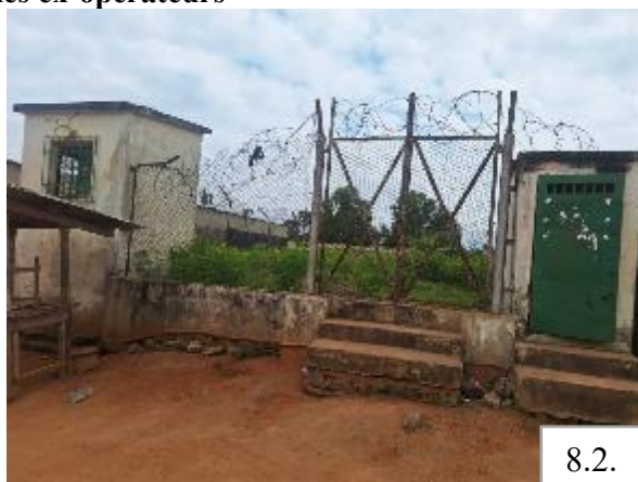
Socle de pylône, clôture grillagée et guérite non-démantelés par ex-opérateur GREEN à Aboisso
