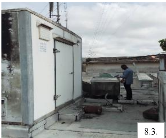
Armoire électrique et pylônes abandonnés à Cocody
