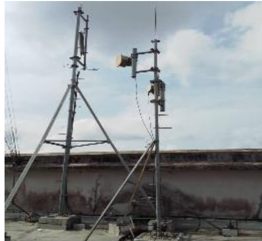
Antenne abandonnée sur site à Abidjan Plateau
