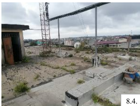
Site abandonné avec pylône non- démantelé à Abobo
