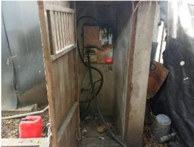
Compteur électrique sous tension à Abidjan Marcory
